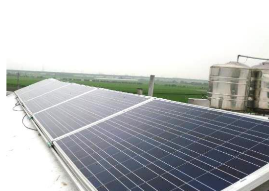
台南市後壁區菁寮國中 4.6kWp
