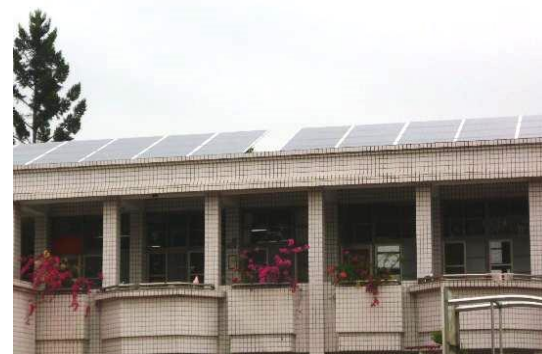
台南市後壁區樹人國小 22.08kWp
