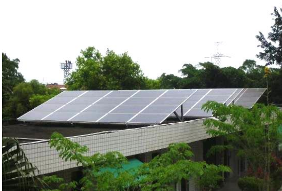
台南市白河區仙草國小 47.52kWp
