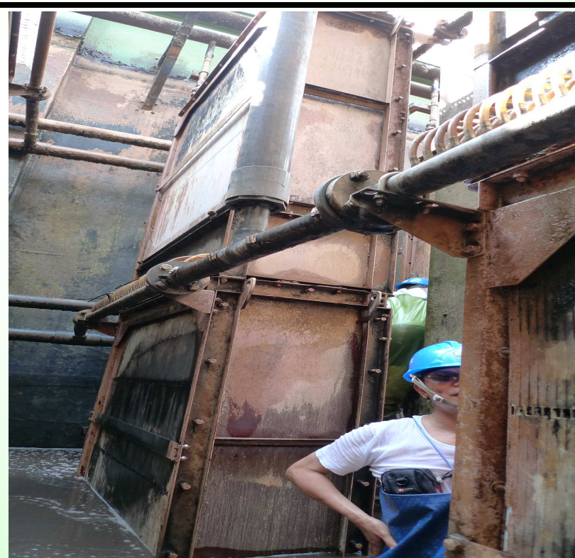
檢查MBR膜片破損情形
