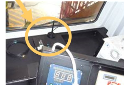
WAVE/DSRC 列車通訊設備(即時影像接收)
