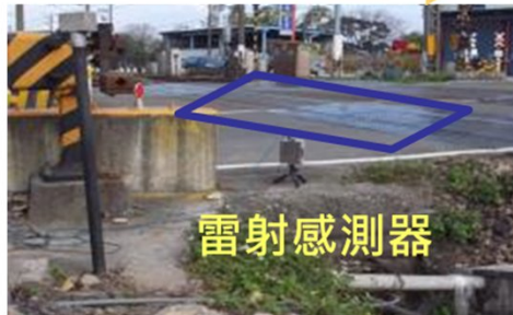
雷射感測器組監測平交道障礙物(藍框區域)
